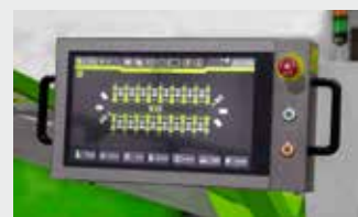
Pannello di controllo principale
